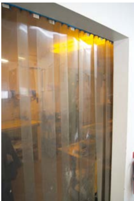
蒸汽阻隔门阻隔附近槽池的雾气或水分进入
